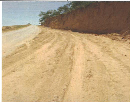
场内检修道路部分临时占地未修复
