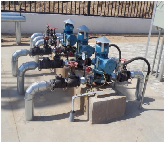
循环水泵及减震基础
