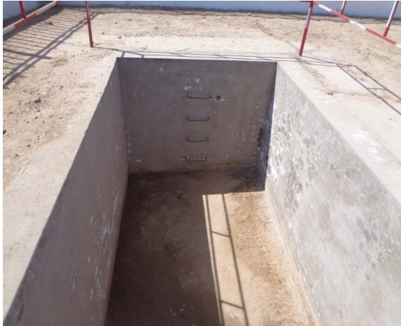
井场事故污油污水池
