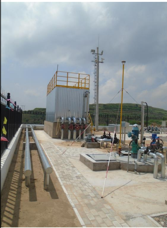
1 具投产作业箱（应急事故池）
