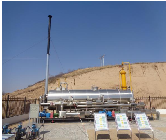
油气混输一体化装置
