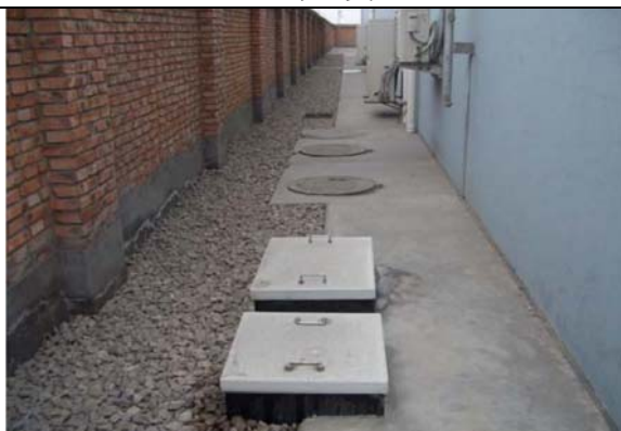
污水处理装置
