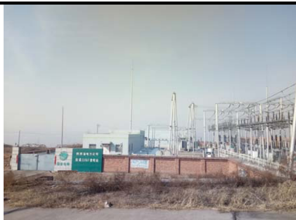
张梁 110kV 变电站现状
