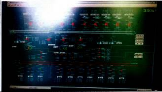
变电站设备运行工况
